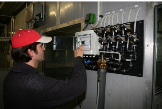
Abb. 7: Meister Joachim Hinterlang stellt die Neopredizid-Anlage ein.
