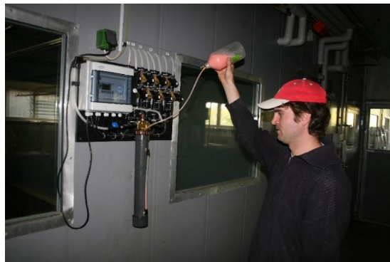
Abb. 8: Meister Joachim Hinterlang füllt die Neopredizid-Anlage auf.
